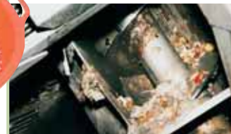
Bei der mechanischen Reinigung wird grobes Schwemmmaterial durch Rechen entfernt. Im Vorklärbecken sinken kleinere Schmutzteile zu Boden.
